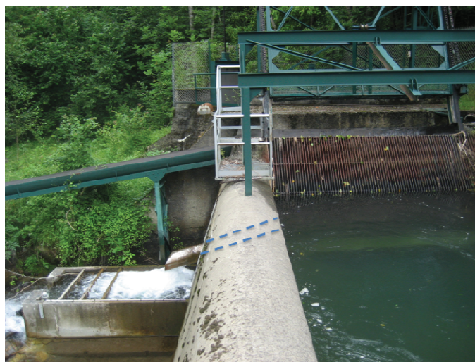
Figure 18 : A gauche, principe d'un piquage sur une conduite; A droite, piquage au travers de la paroi du canal d'amenée de la prise d'Estaing Inférieur (GU Val d'Azun)
