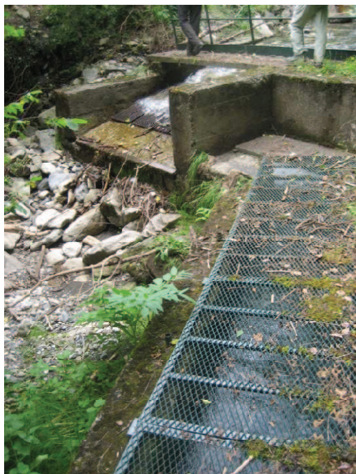
Figure 7: Exemple d'une prise d'eau de montagne équipée uniquement de grilles et d'un canal d'amenée (prise de Benciole, GU Val d'Azun)
