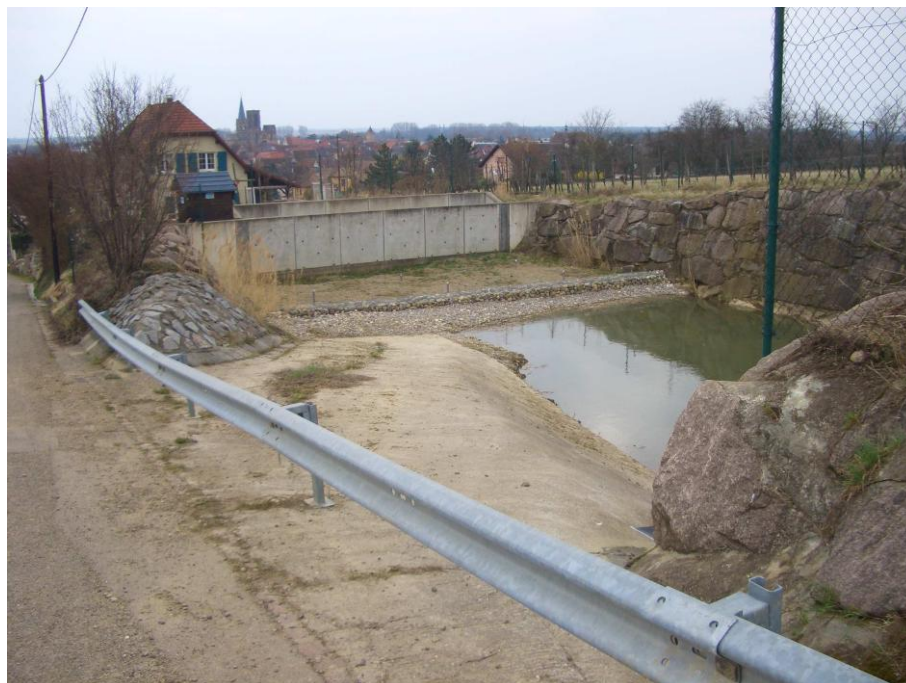
Figure 10 : bassin d'orage du Waldweg à Rouffach (photographie ArtWET)
