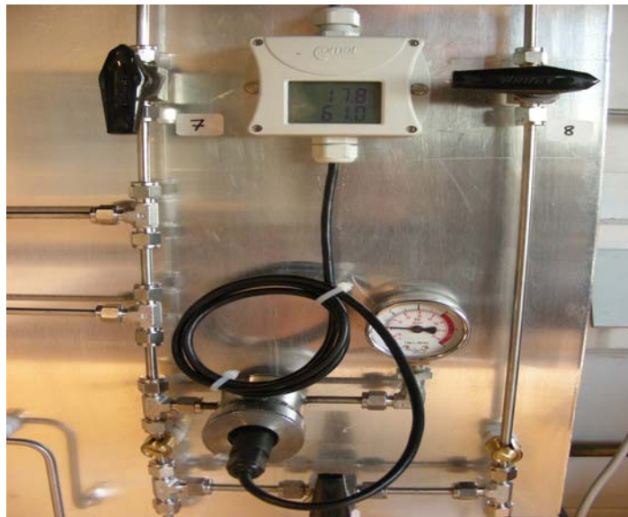
Figure 2.26 : Positionnement du thermo-hygromètre (sonde et afficheur), ainsi que le manomètre du réseau gaz.
