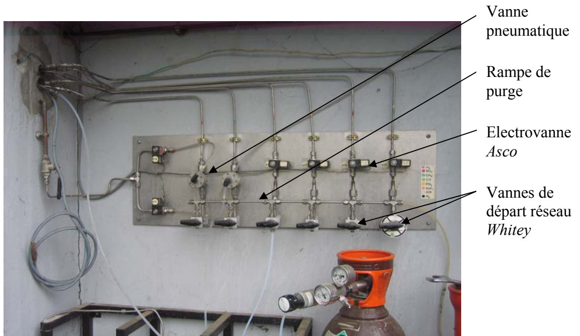
Figure 2.1 : Panoplie inox du local de stockage extérieur de bouteilles de gaz avant modification.
