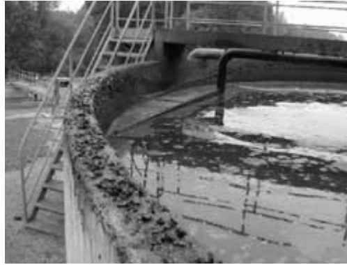
Figure N°51 : Dégradation du béton d'un voile de bassin d'aération
