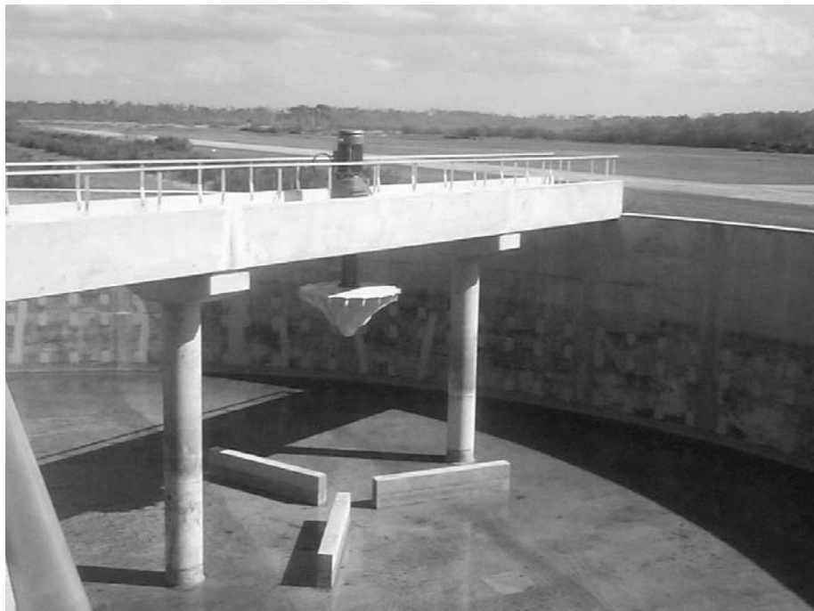
Figure N°38 : Bassin aéré mécaniquement par des turbines de surfaces
