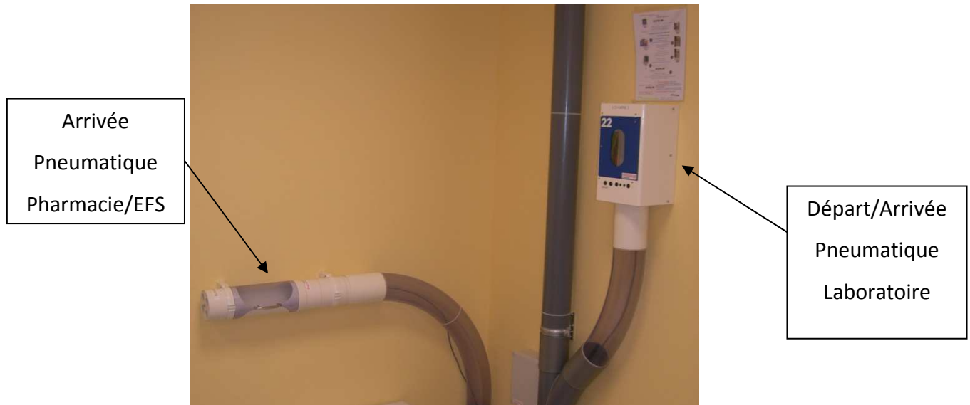
Figure 58 : Arrivée des réseaux pneumatiques dans les unités de soins
