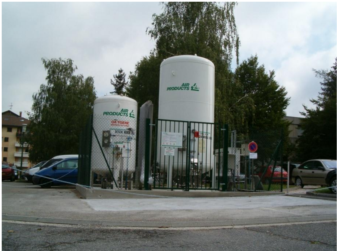
Figure 11: Réservoir hospitalier - document Air Products
