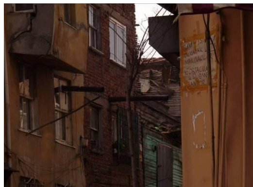
Figure 47 : Dégradation du bâti dans un quartier central
