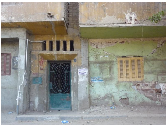
Figure 13 : photo d'un logement raccordé au gaz au mépris des normes de sécurité
