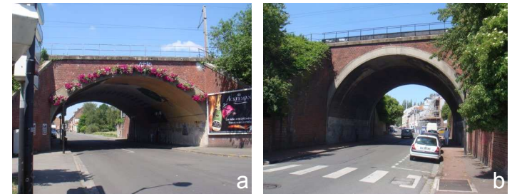
•23• Photographie des ponts SNCF rue du Grand chemin (a) et rue des Arts (b), Roubaix, Pauline Prévoté, 2012
