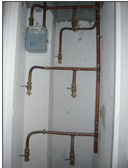
Illustration II-15 : placard à compteurs dans l'immeuble cité ci-dessus : l'installation en cuivre est réalisée, mais les habitants ne disposent pas tous d'un compteur gaz naturel. Photo HB, 2012.
