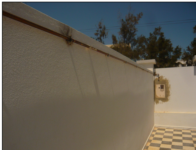
Illustration II-11 : installation évoquée ci-dessus, premier tronçon partant du boîtier contenant le compteur. Photo HB, 2012.
