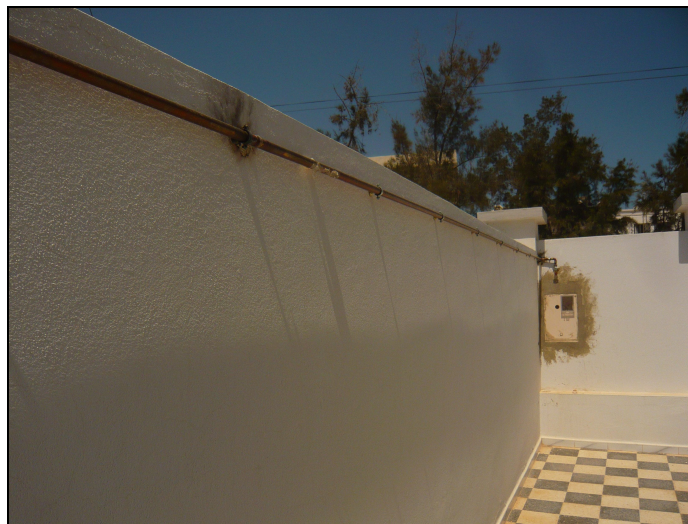
Illustration II-11 : installation évoquée ci-dessus, premier tronçon partant du boîtier contenant le compteur. Photo HB, 2012.
