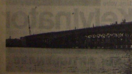
Le pont sur la Vienne, unissant Naintré et Châtelleraut, sera-t-il mis en service en juin ? Les travaux avancent et les voies de raccordement sont prêtes.
