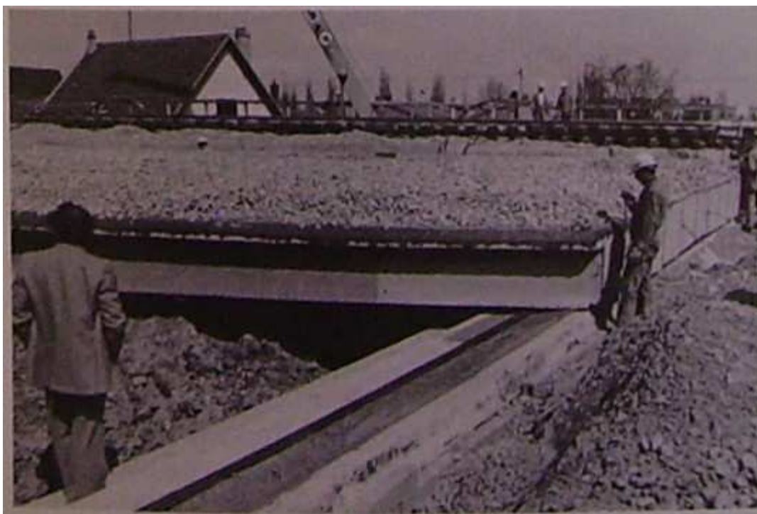
Perçement de la voie sous la voie ferrée et construction du tablier du pont.
