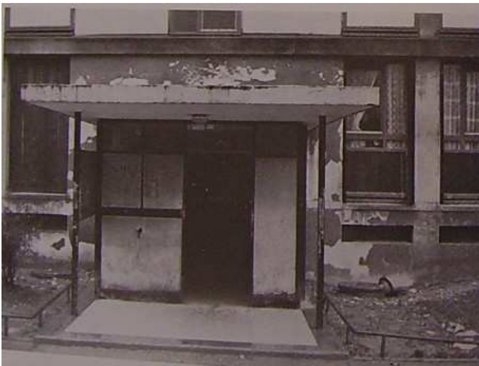
Exemple d'une entrée délabrée d'un immeuble.
