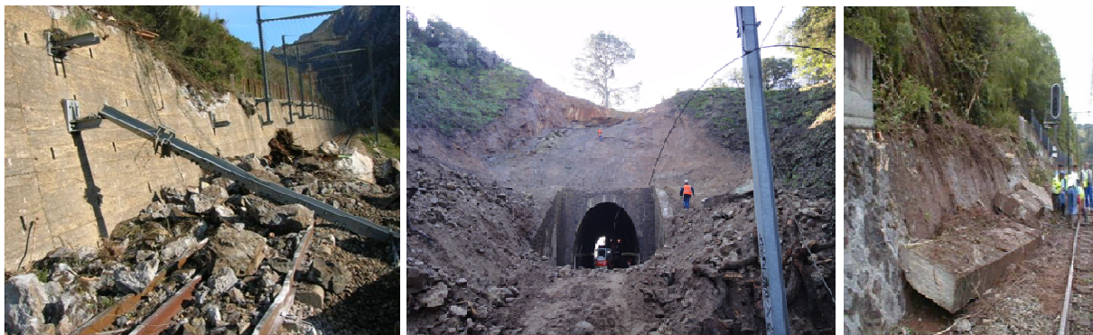
Illustration 2.1 - Chute de blocs sur les voies ferrées - Source : SNCF
