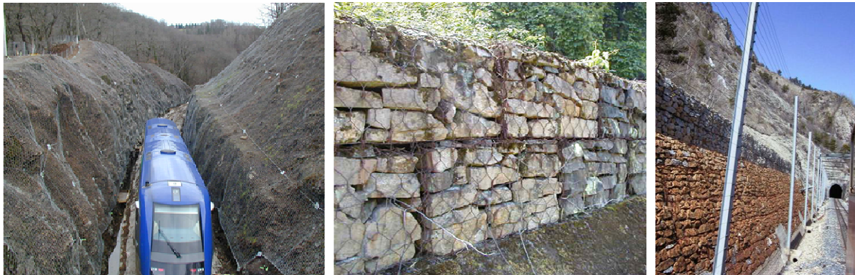
Illustration 2.2 - Exemples de parades actives et passives. De gauche à droite : grillage plaqué ancré, écran gabions et un filet détecteur - Source : SNCF
