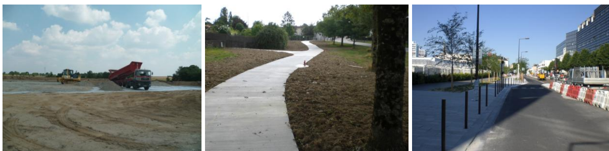
Figure 3 : Illustration de la diversité des typologies de chantier (de gauche à droite : Terrassement et empierrement d'une plate-forme de 5000m 2 (Saint Germain Sur Moine – 49), Cheminement en béton balayé (La Roche Sur Yon – 85), Plantation et mobilier (Ile de Nantes – 44) (Gourvès, 2013).
