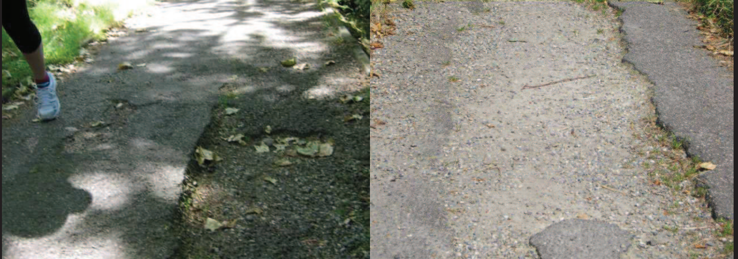
Fig. 7 : Des chemins piétons en mauvais état
