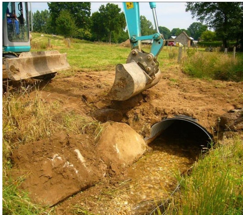
Figure 30 : Mise en place d'un demi-tube en dessous d'un passage agricole (photographie issue du site de la CCBM [17] )
