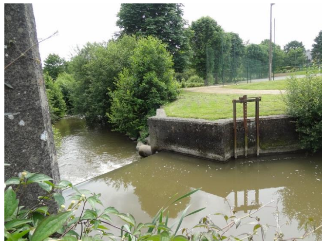
Figure 6 : Clapet de l'ancienne piscine à Gorrion (Clapet 2) (Gorrion, 2013, Lefèvre Amandine)
