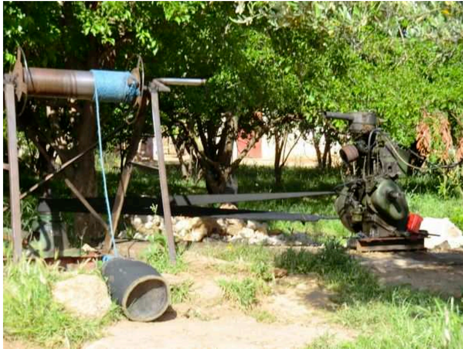
Figure 71. Puits équipé d'un moteur et d'une pompe. Réalisation : Gameroff et Pommier
