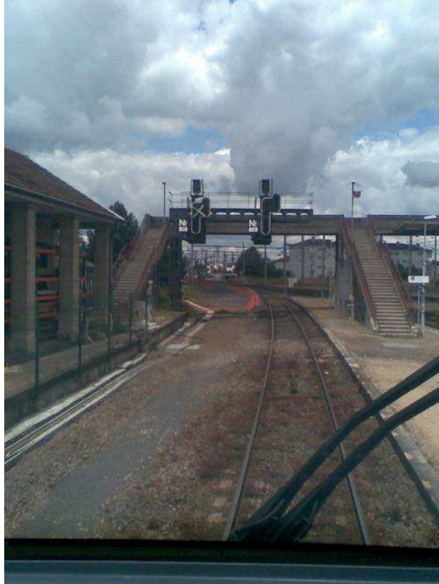
Figure 44: Photo prise de la cabine conducteur d'un AGC en provenance de Pont-Saint-Vincent : Début des travaux de création de la 3ème voie entre Nancy et Jarville
