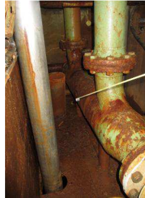
Figure 13 : oxydation de la canalisation principale (station de pompage de Laméjoul, 11/03/2013, V. Frizon de Lamotte)
