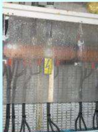
Condensation dans les armoires électriques
