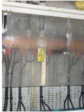
Figure 12 : condensation à l'intérieur des armoires électriques (station de pompage de Laméjoul, 11/03/2013, V. Frizon de Lamotte)
