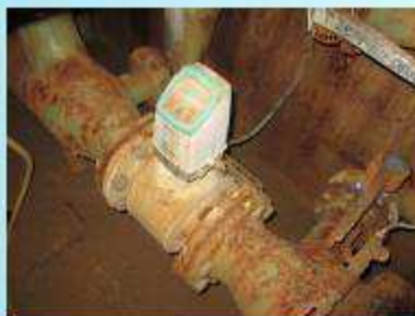
Canalisation au niveau du débitmètre
