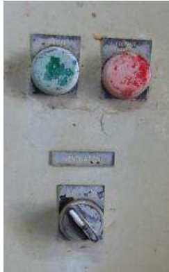
Figure 11 : dépôts calcaire sur la façade extérieure des armoires électriques (station de pompage de Laméjoul, 11/03/2013, V. Frizon de Lamotte)
