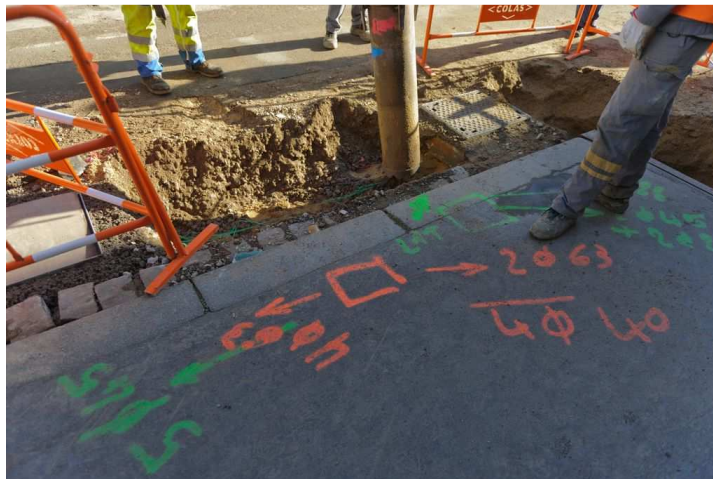
Figure 1 - Marquage au sol d'un réseau électrique (couleur rouge) et d'un réseau de télécommunication (couleur vert), auteur: Arnaud Bouissou – MEDDE
