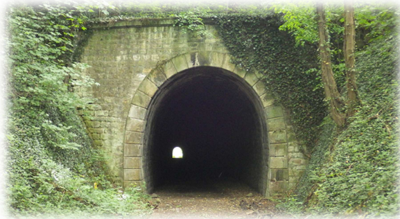
Figure 18: Entrée Nord du tunnel de la Croix de Marlet (275m) © Alban DOUSSON, SEM
