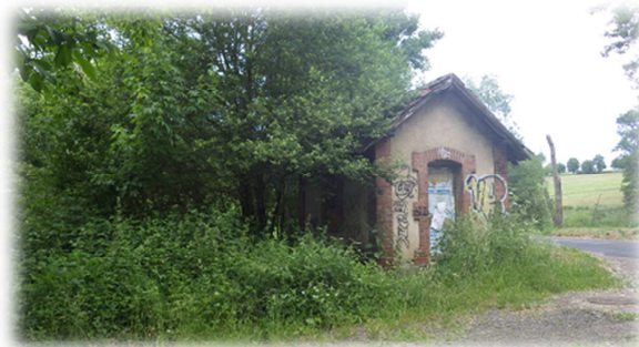
Figure 21: Maison de garde-barrière désaffectée sur St-Victor-sur-Loire © Alban DOUSSON, SEM
