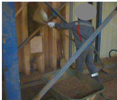
Figure 5 : Remplissage des goulottes d'alimentation
