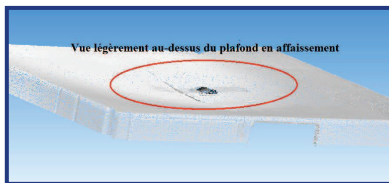
Figure.28 : Exemple d'un plafond en affaissement
