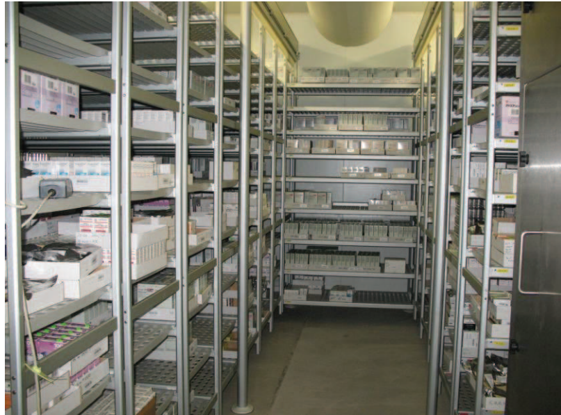
Figure n°19 : Photographie de l'intérieur d'une enceinte climatique
