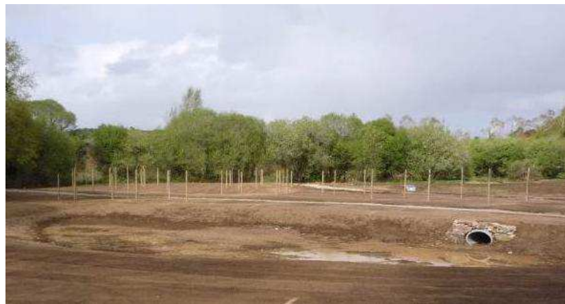
Figure 22 Photographie d'un des bassins de rétention (Agence ENET-DOLOWY, 2011)
