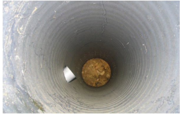
Fig. 10 : Puits d'infiltration (Source : http://legoenpaille.free.fr )
