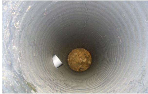
Fig. 10 : Puits d'infiltration (Source : http://legoenpaille.free.fr )
