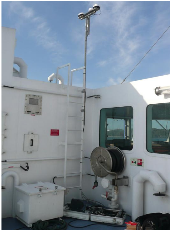
Illustration 26: Mât comprenant les trois antennes
