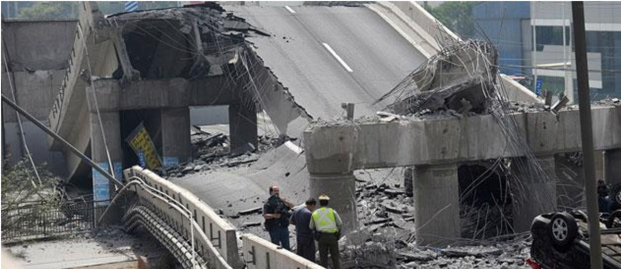
Photo 4 : Effondrement d'un pont dans la capitale Santiago du Chili, source : http://www.lepoint.fr/content/system/media/1/201002/84207_chile-une.jpg .
