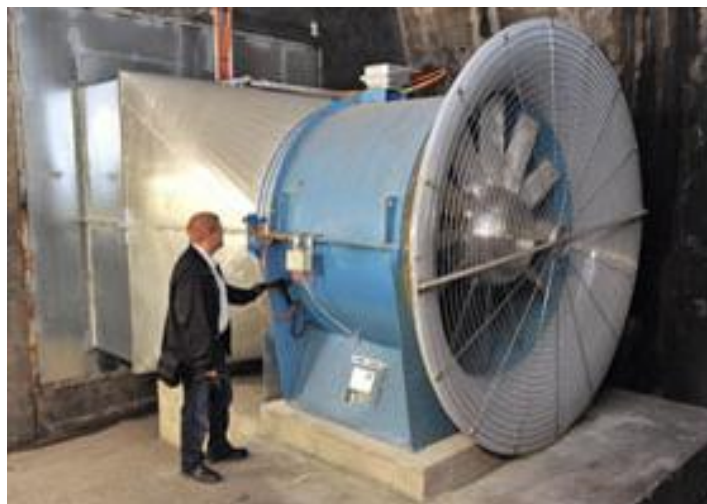
Fig. 6 Ventilation pour le rame du metro, Consulté le 25 avril 2013 Source : le site RATP
