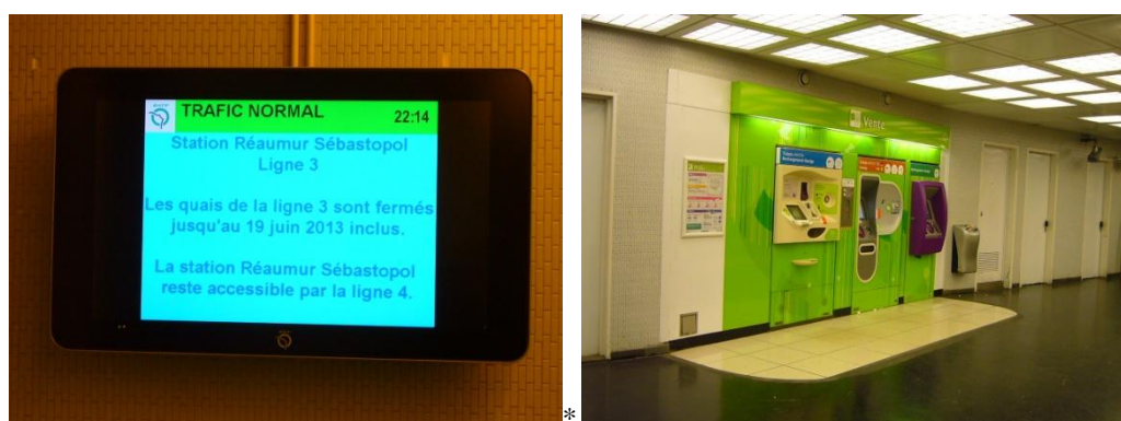
Fig. 34 Dispositifs électriques existants dans le métro
