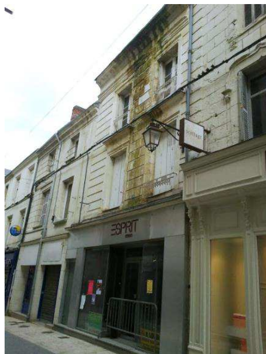
Local commercial et logements vacants, façade et logements dégradés en centre-ville ©Ville de Châtellerault
