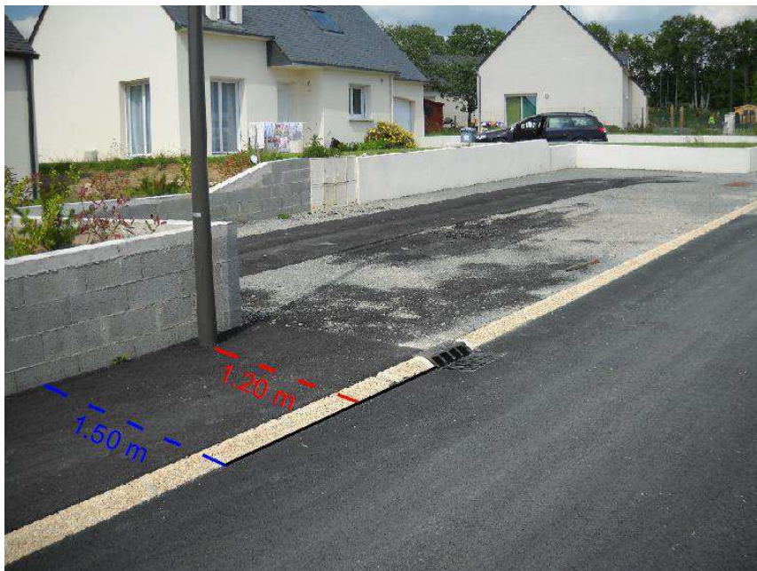
Exemple d'un rétrécissement du cheminement piétonnier dû à la présence des candélabres
