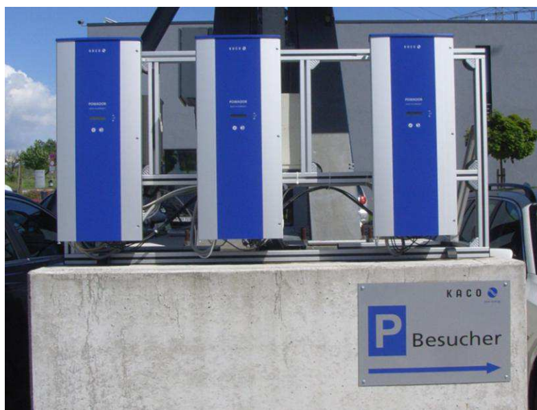
Photographie 9 : Onduleurs sur le parking de KACO new energy à Neckarsulm
