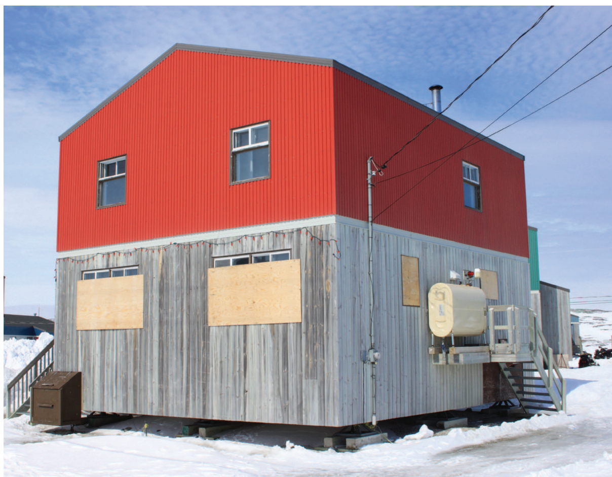
Exemple de dégradations sur les vitrages d'un habitat HLM à Akulivik. Source : Photographie durant le voyage à Akulivik en mai 2013.
