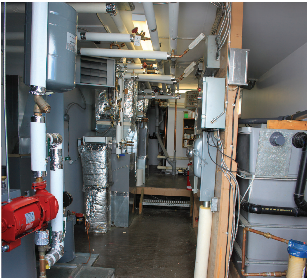
Salle mécanique d'un modèle Multifamilial à Akulivik. Source : Photographie durant le voyage à Akulivik en mai 2013.
