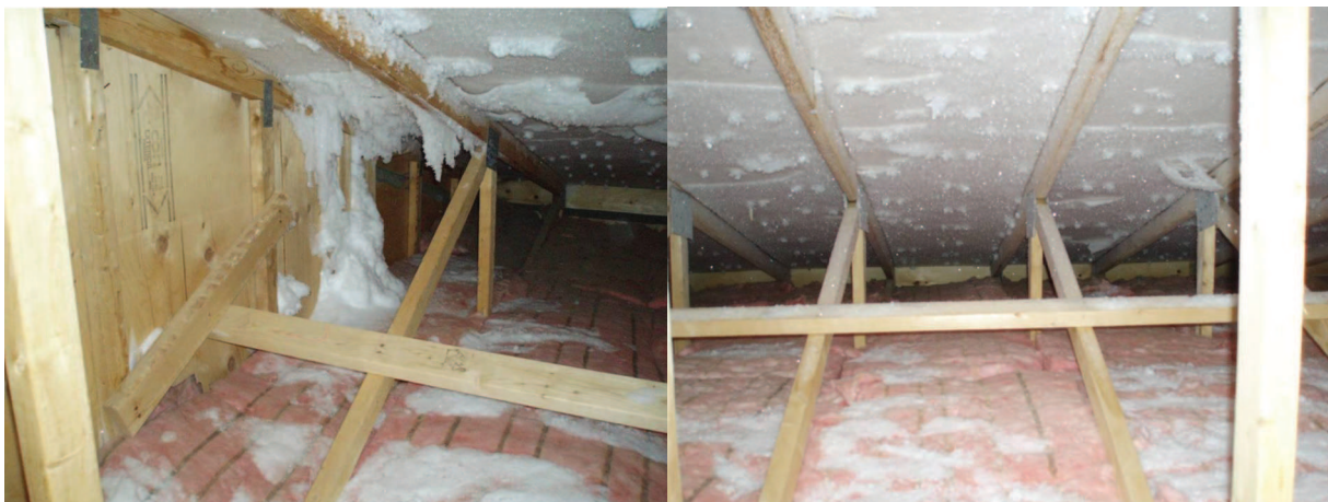
Infiltration de poussière, de neige et de condensation dans un entretoit. Source : SHQ
