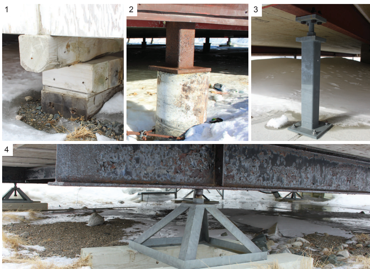
Types d'empattements : sections de bois (1), pieu (2), colonne (3) et verin métallique ajustable (4). Source : Photographie durant le voyage à Akulivik en mai 2013.
