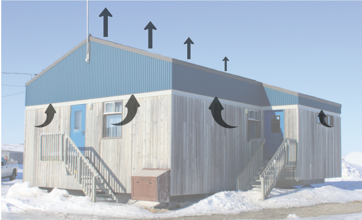
Aspiration de l'air sous le parement de tôle et le filtre média bloquant la poussière de neige et évacuation de l'air au faîtage. Source : Photographie durant le voyage à Akulivik en mai 2013.
