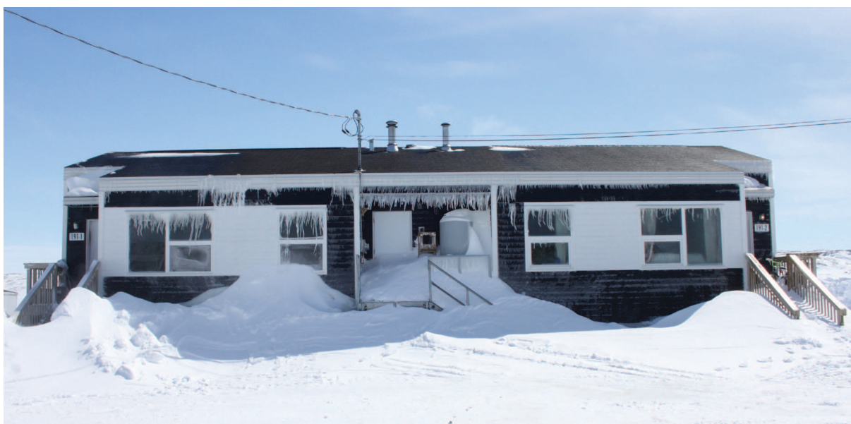
Construction après une tempête de vent et de neige. Source : Photographie durant le voyage à Akulivik en mai 2013.
