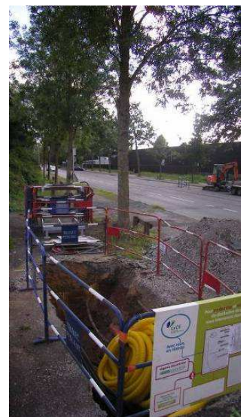
Figure 9 : Photographie de l'excavation d'une tranchée technique au pied des arbres, Promenade de la Baumette - Angers (49). (Gouédard, 2014)
