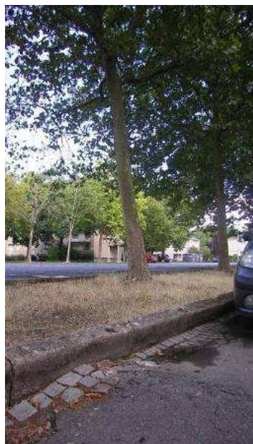
Figure 26 : Photographie d'une racine de Platane soulevant le revêtement de voirie (Place de la Dauversière à Angers), faute de disposer d'un volume de terre suffisant pour se développer. (Gouédard, 2014)
