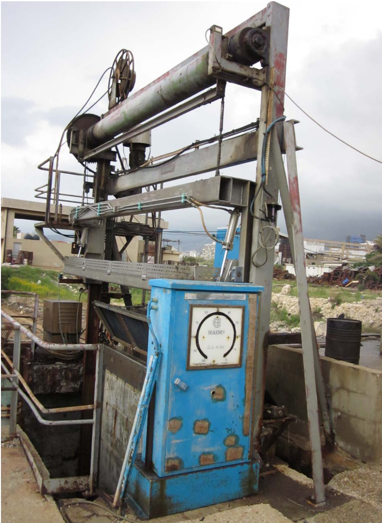
Figure 2: dégrilleur à râteau type s, vue latéral
