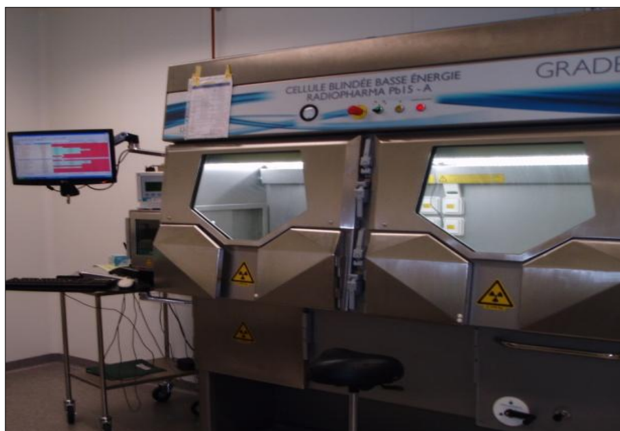
Figure 6. Enceinte blindée pour la préparation et la dispensation des préparations technétiées
