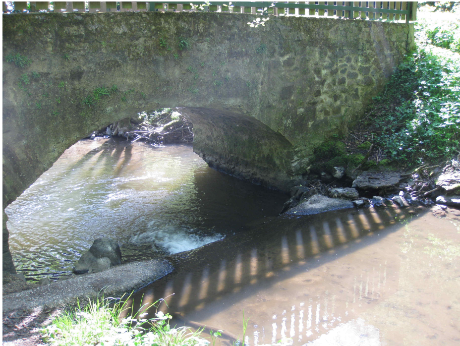
FIGURE 18 – Photo de la section de contrôle actuelle de la station hydrométrique de Craponne.
