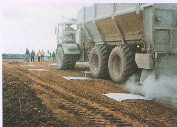
Positionnement aléatoire des baches sur chantier.
