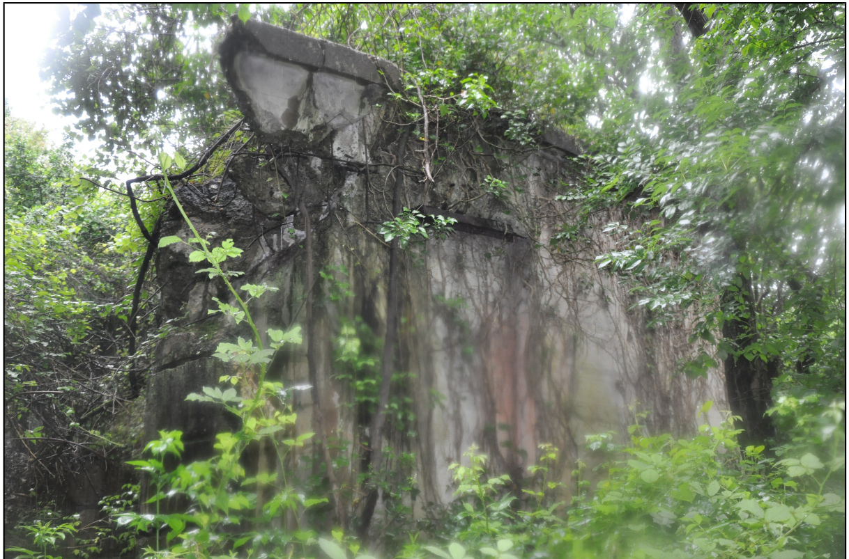
Figure 74 : Casemate envahie par la végétation, Hendaye. (Photo A. Quercilhac)
