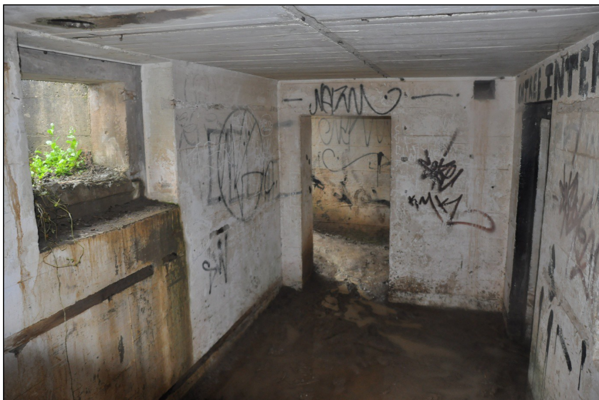
Figure 34 : Poste d'observation SK. (Photo A. Quereilhac)
