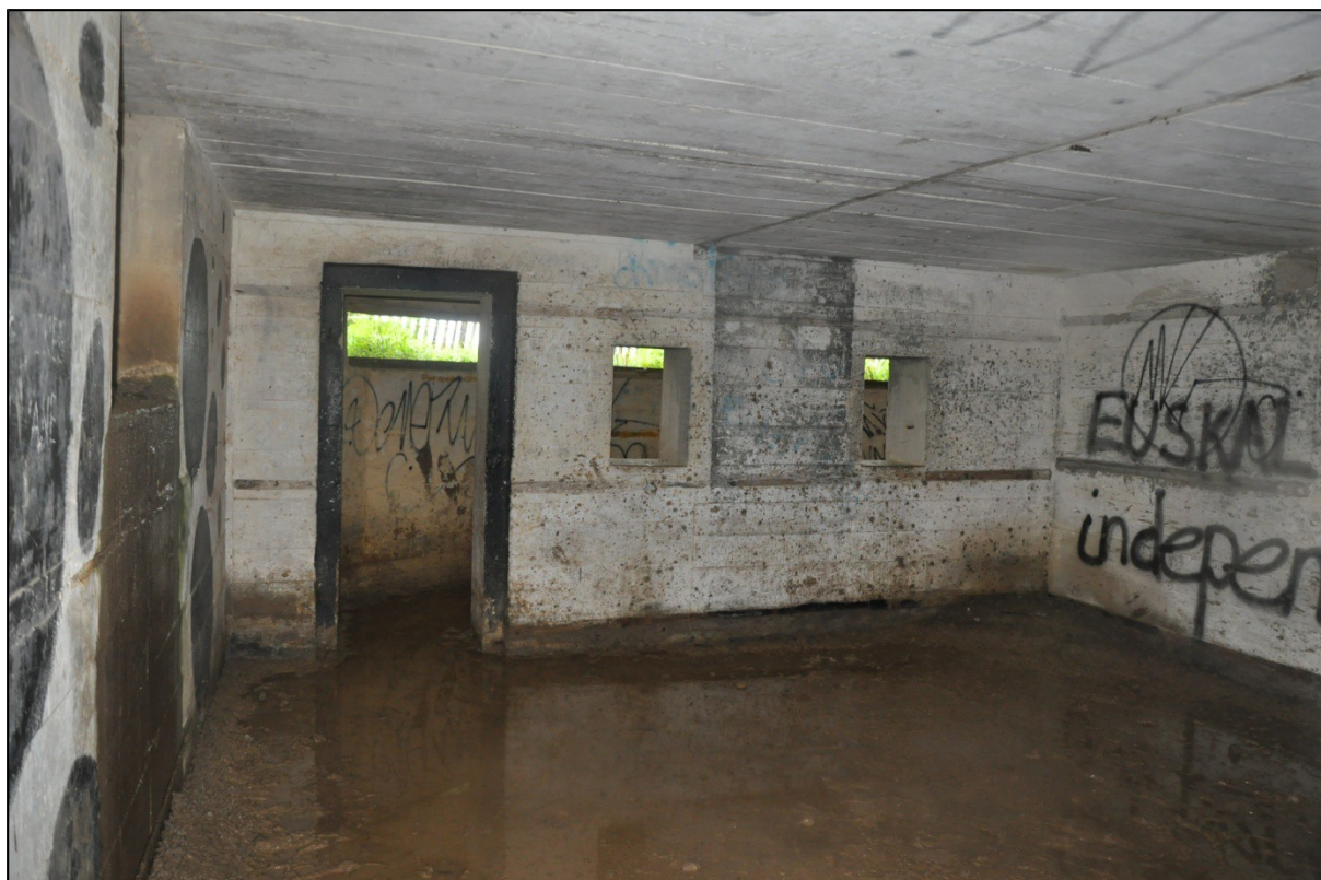
Figure 33 : Poste d'observation SK. (Photo A. Quereilhac)
