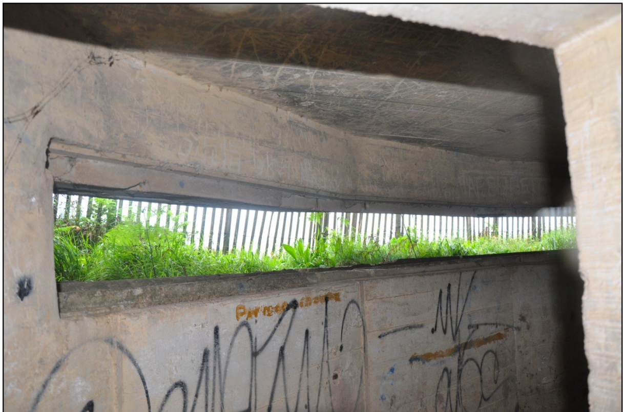
Figure 32 : Poste d'observation SK. (Photo A. Quereilhac)
