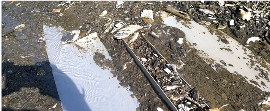
Figure 18: Ailettes installées sur la trappe à fente
