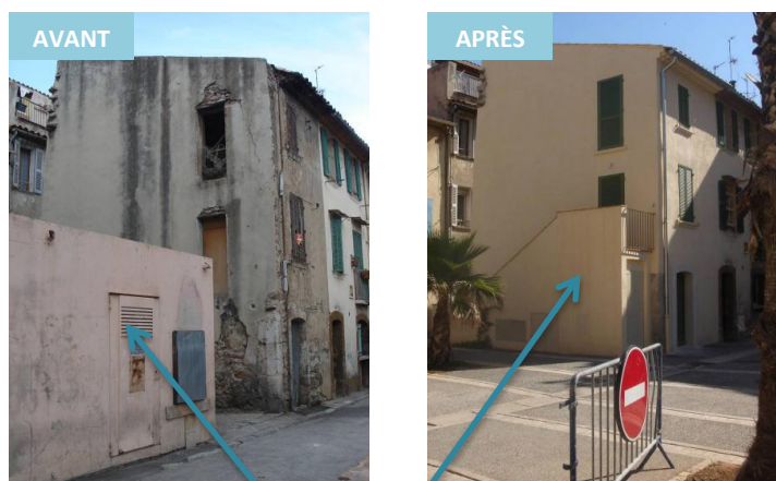
Figure 38 : Phase de démolition de la sanisette et du transformateur avant et après
