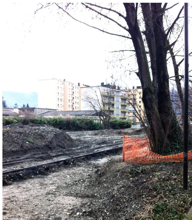
Figure 80/ Exemple de protection du tronc insuffisante sur le chantier de la ZAC Flaubert à Grenoble.
