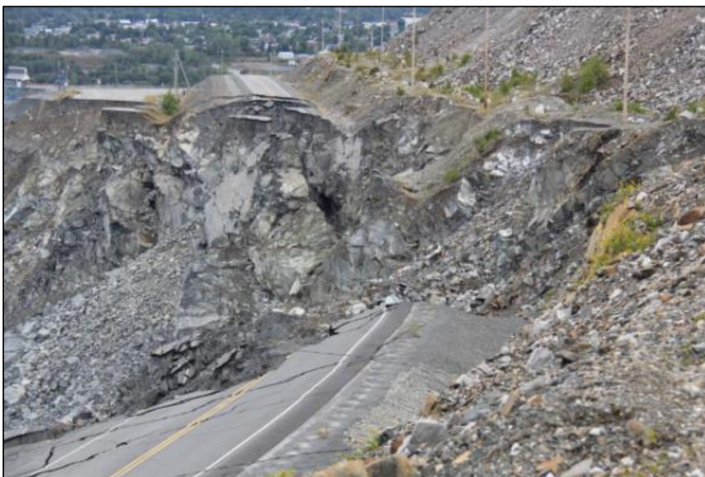
Figure 10 : Affaissement de la route 112 (2 août 2012)
