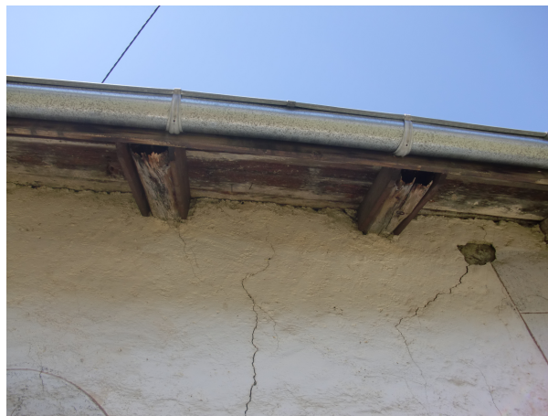
Fig. III.24 – Poussée du toit et déversement des murs gouttereaux : fissures en haut des murs, maçonnerie abîmée
