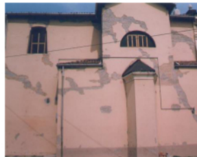
Fig. III.62 – Fissures en X, compression et traction alternées : Église S. Michele Arcangelo, Bagnolo, Italie
