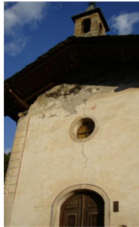
Fig. III.64 – Fissure verticale à l'aplomb de la porte, déplacement des murs gouttereaux : Chapelle St Pantaléon, Grand Gondon, Bourg-Saint-Maurice, France
