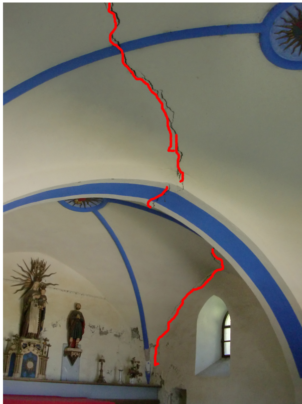
Fig. III.21 – Fissures dans la nef et le chœur, chapelle Notre Dame du Mont Carmel, La Combe, Saint-Gervais, Août 2013
