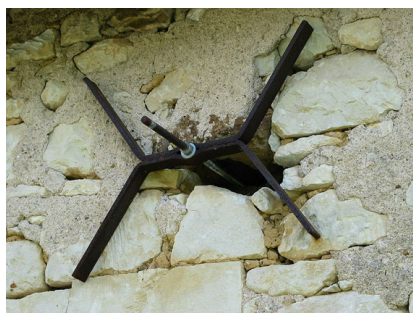
Fig. I.31 – Confortement traditionnel : clé et tirant métalliques
