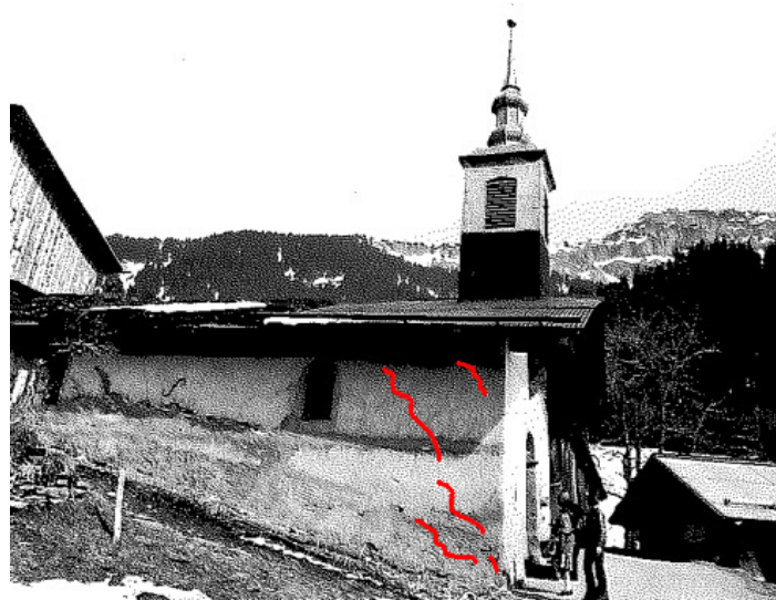
Fig. III.13 – Fissure en V sur la façade ouest en 1986, avant restauration, Archives Départementales du STAP
