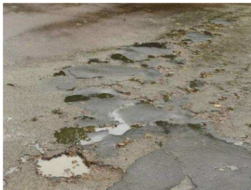
Figure 96 : Exemple de rétention d'eau sur la voirie en fonction des aspérités / irrégularités
