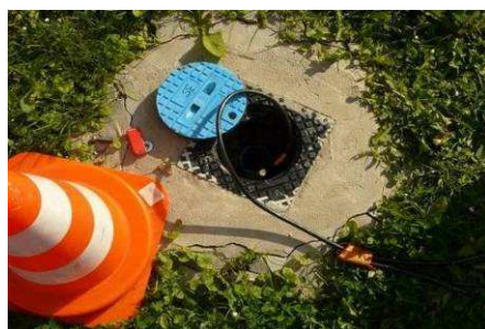
Figure 40 : Photo de relevé des mesures piézométriques
