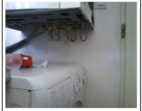
Photo 10 : Chaudière placée dans la cuisine
