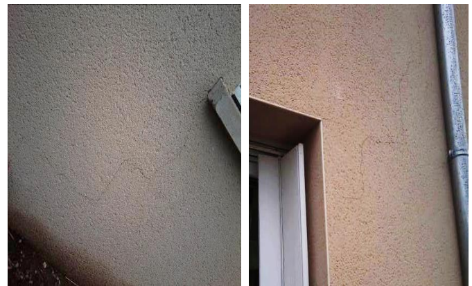
Photo 9 : Fissures sur le mur extérieur
