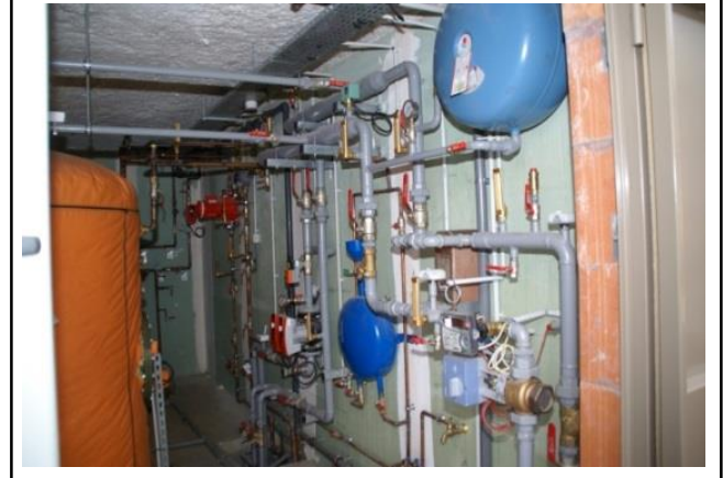
Photo 2 : Sous-station eau chaude collective
