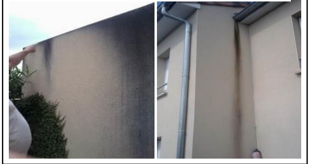
Photo 11 : Traces d'humidité liées à un défaut d'étanchéité
