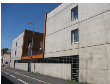
Figure 8 : Problème du traitement des façades... (source : A. Moreau)
