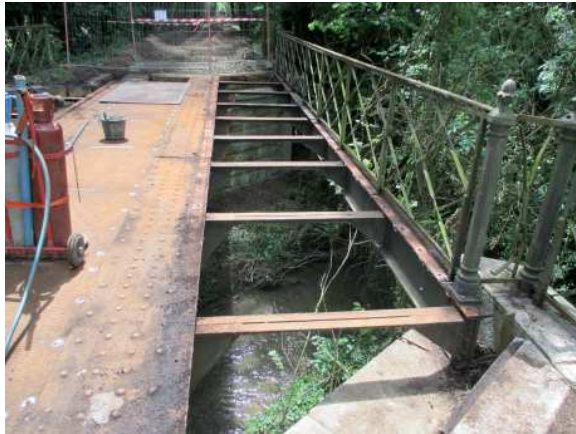
Figure 8 : Photo de suivi du chantier de la voie verte de Baugé (source : Philippe Rigoussen)
