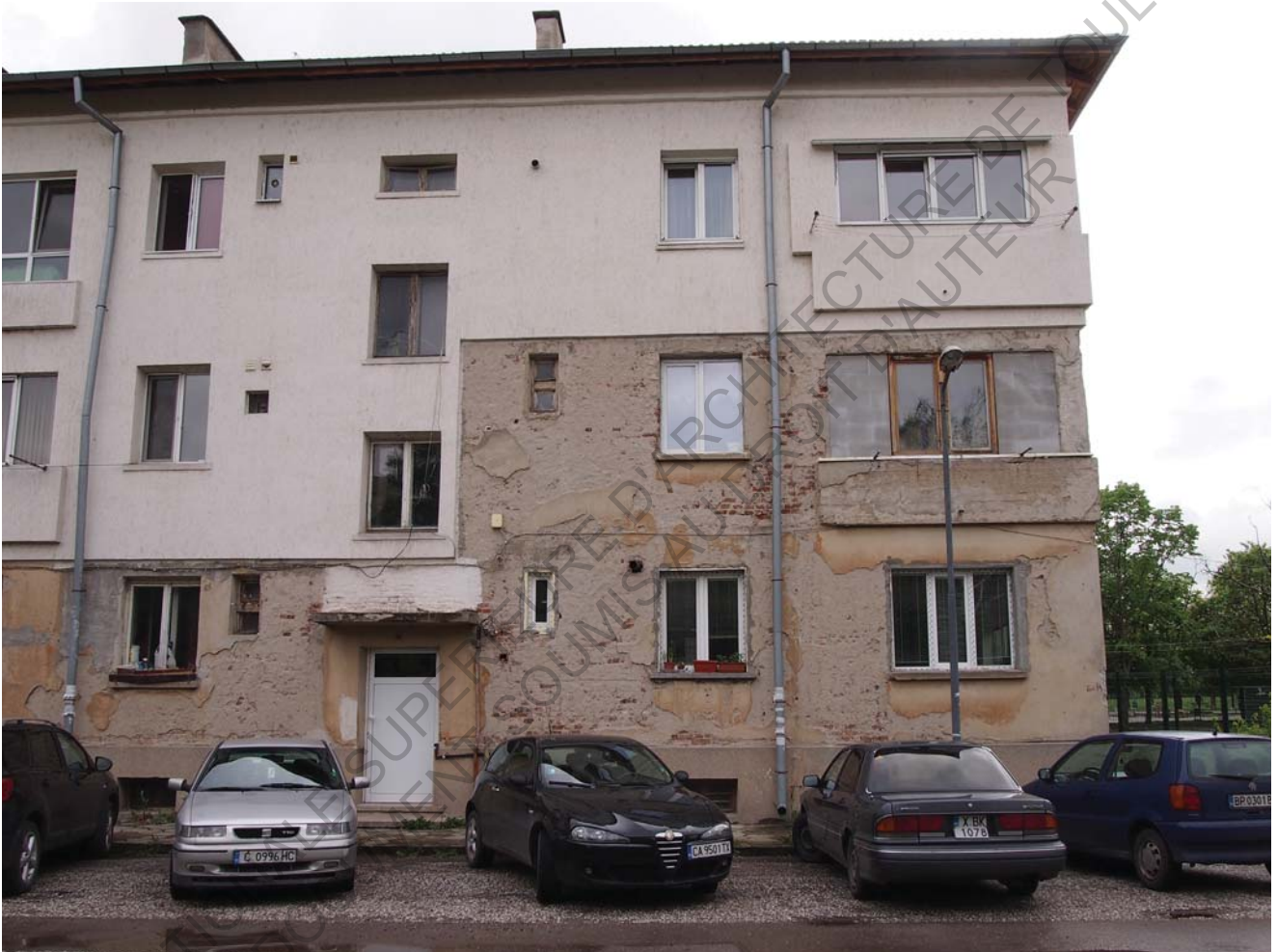
Figure 25 : Un mauvais état des immeubles d'habitation (Drujba 1) (C.FICAT)
