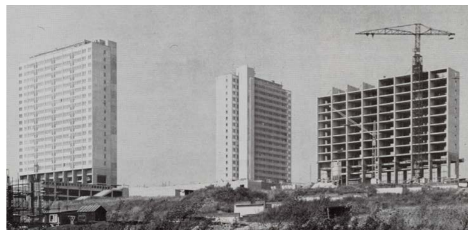
Fig 22. Photographie des tours 1 et 3 construites, la tour 3 en construction. (Source: La technique des travaux n°9-10, 1966.)
